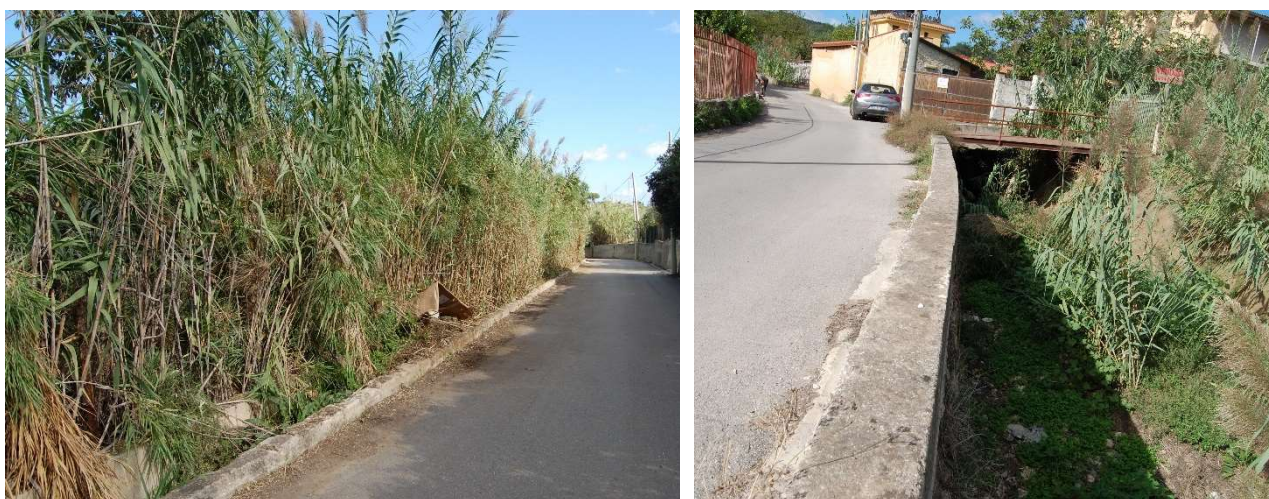
Fig- 7.5 – Strada Comunale Ranteria: Il canale di scolo intasato dai canneti (a) e la sezione in prossimità del Ponte Castronovo (b) nodo con la SP16 (Foto Lithostdi)
