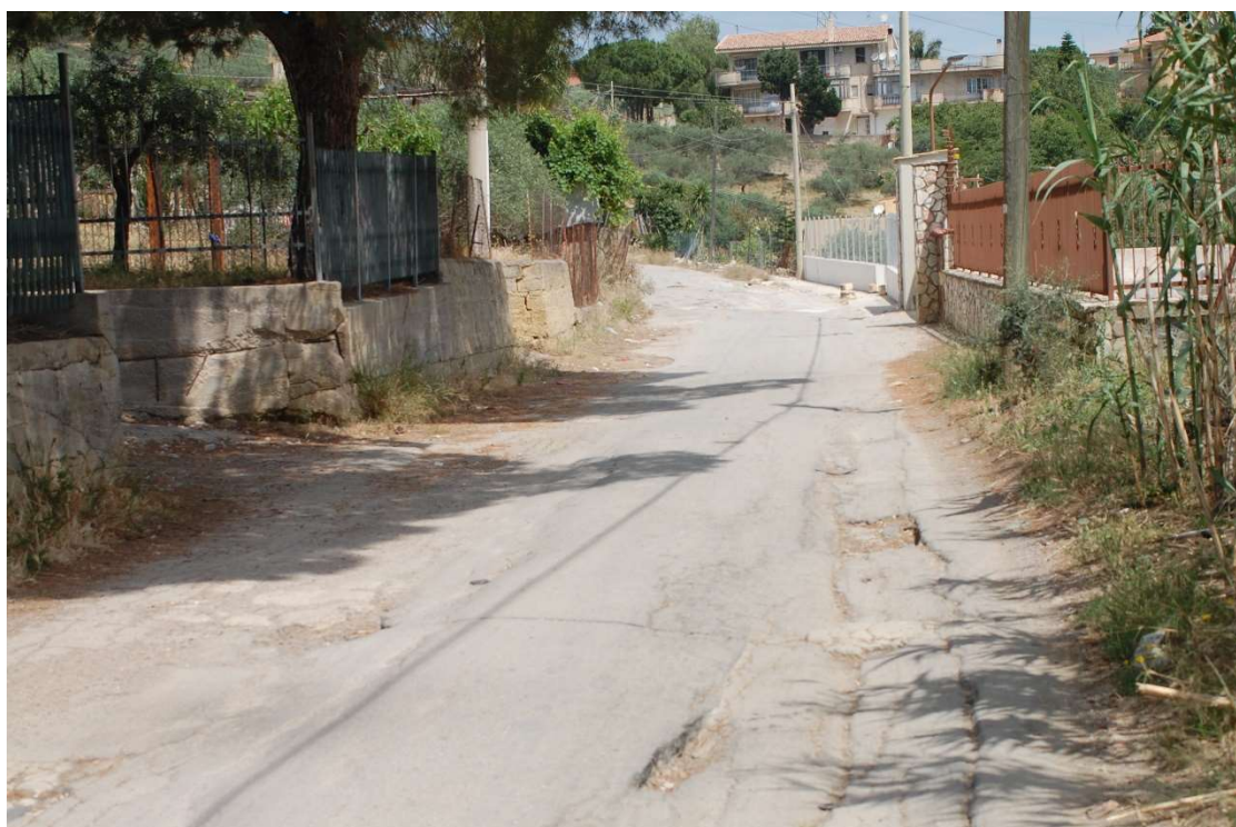
Fig. 7.4 – Deformazioni del manto stradale in località Torre Amalfitano
