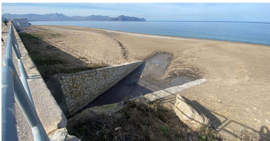
Fig. 7.3 – Sbocco del collettore fognario (Foto Litostudi)
