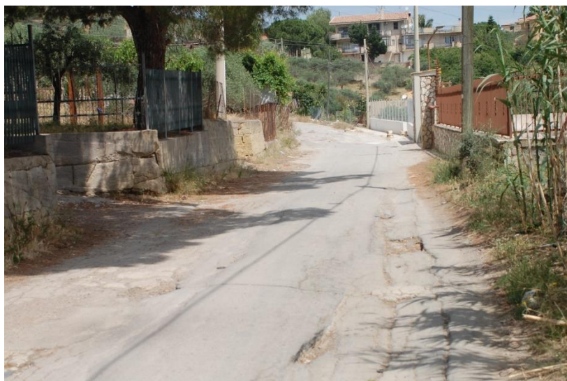
Fig. 4 – Deformazioni del manto stradale in località Torre Amalfitano
